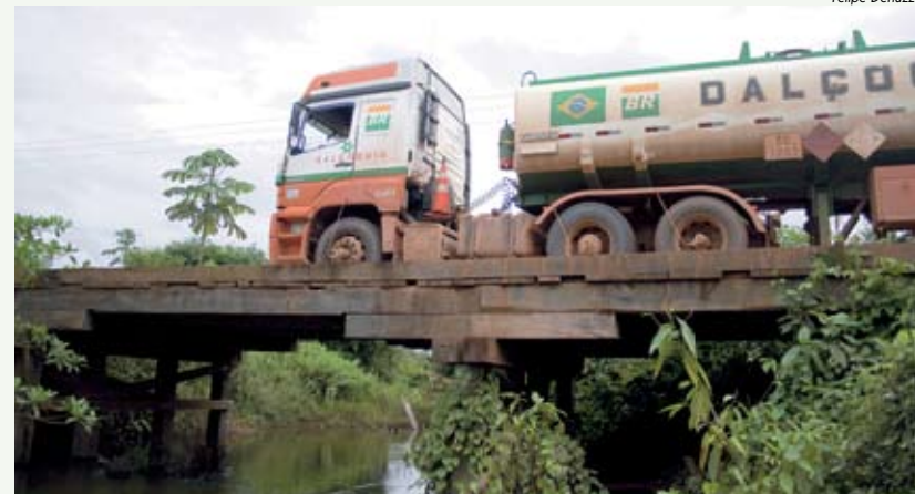
As pontes de madeira substituíram os troncos de madeira, mas ainda são inseguras.
